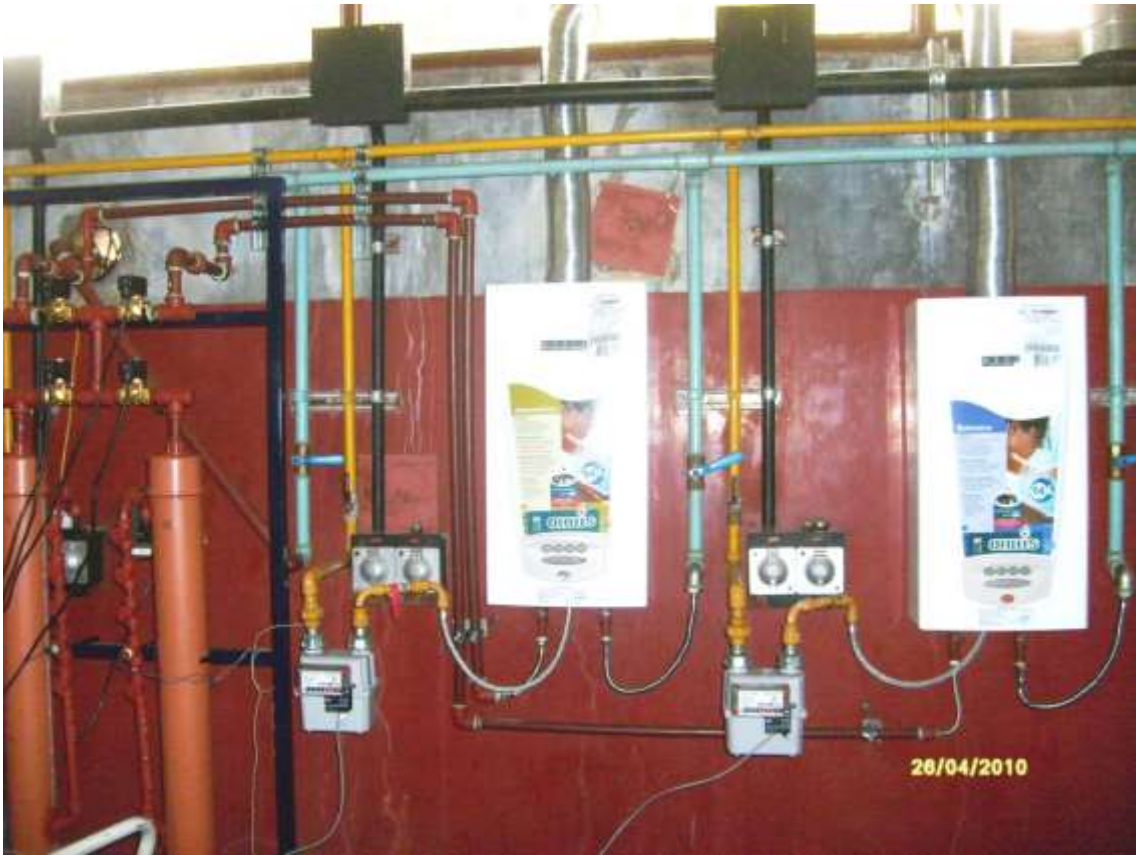
Figura 6. Sala de ensayo de los Calefones en los laboratorios de INTI Energía.
